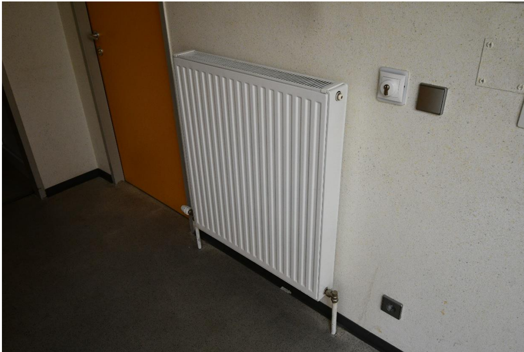
Bild 21: Heizkörpertyp 1 – Flachheizkörper mit Thermostatkopf
