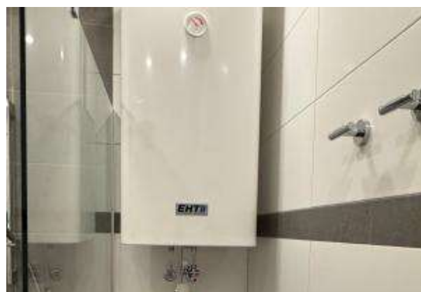
Boiler und Waschmaschinenanschluss
