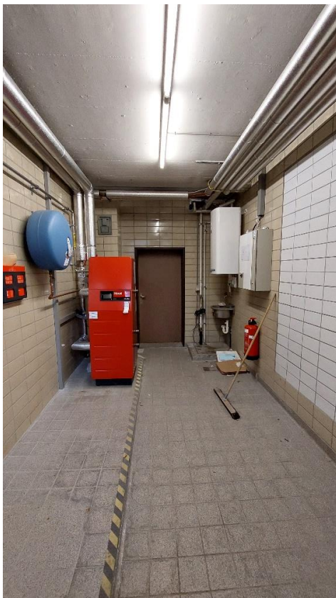
Heizraum U1.03 im KG
