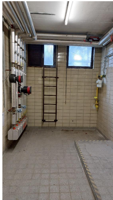
Heizraum U1.03 im KG
