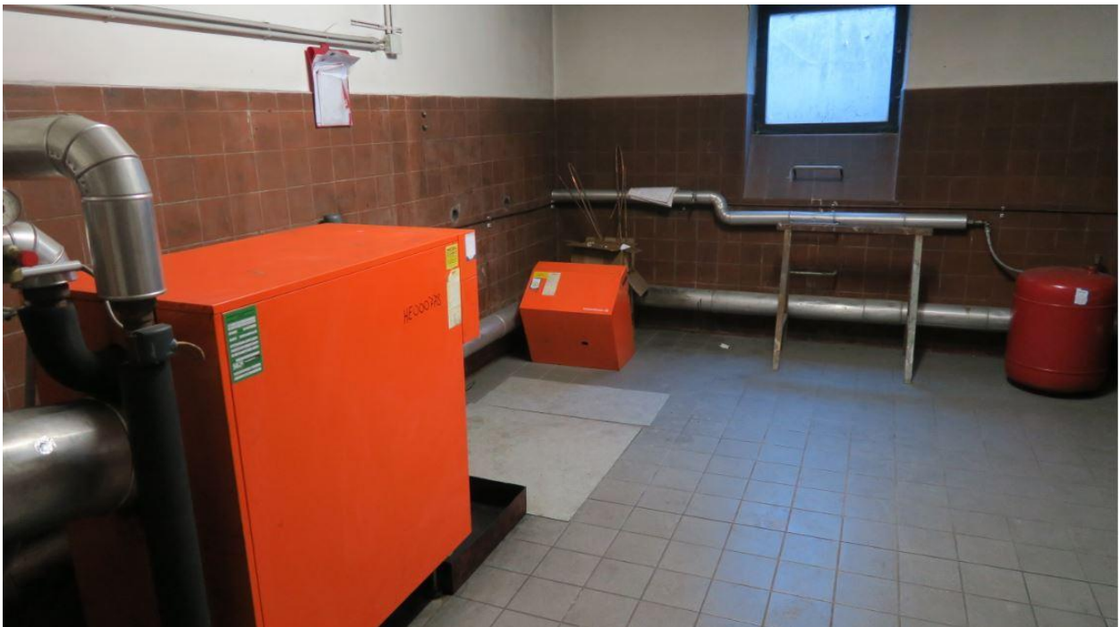
KG – Heizraum – Raum U1.09
