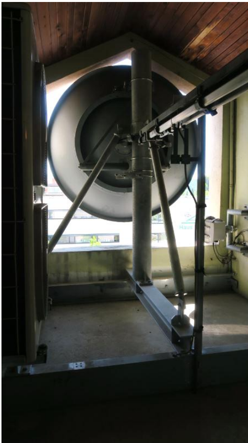
A1 TA AG - Richtfunk – DG - Raum 2.02A
